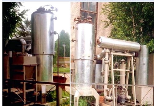
Рис. 9. Схема сжигания топлив в кипящем слое катализатора и опытно-промышленная автономная теплофикационная установка КТУ-2 мощностью 500 кВт для сжигания твердых топлив (высота 2,5 м.).
